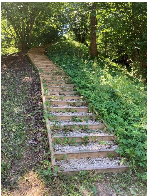
Foto 107. Vaade vähese hooldusega trepistikule. Taimestik võib soodustada rajatise kiiremat lagunemist. 2021. Foto autor: Kreeta Sipelgas. 181
